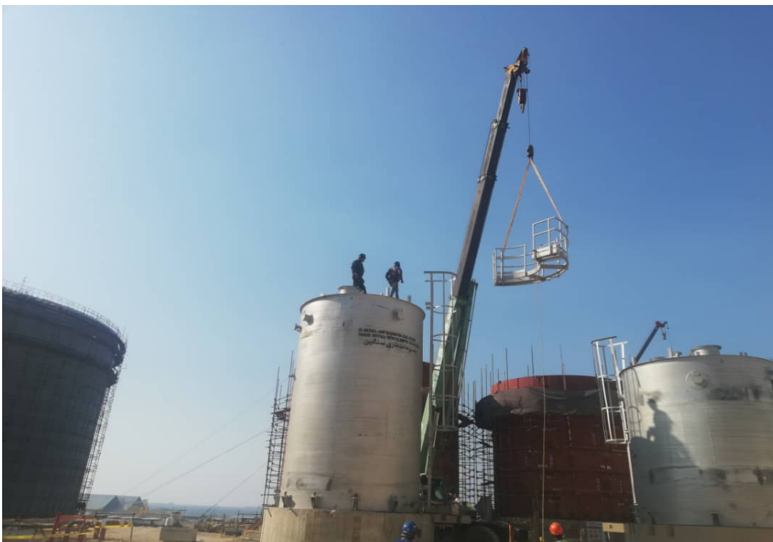
پروژه ساخت و نصب ۵ عدد مخزن اوره و آمونیاک پتروشیمی لوان - عسلویه
